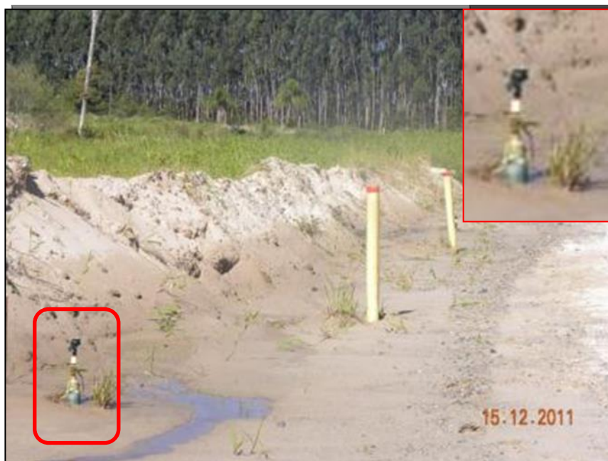
Foto 3.01: Sistemas de aspersores ao longo da via de acesso.
