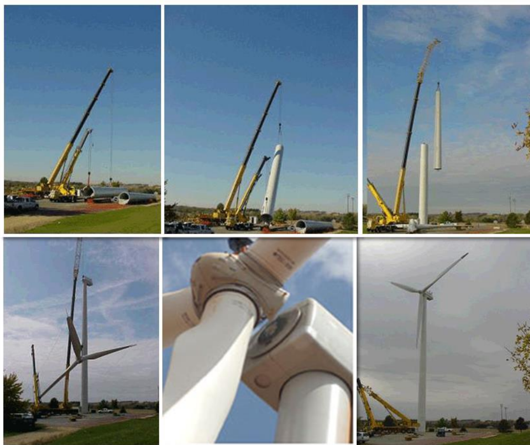
Fig. 3.10 - Sequência de montagem do aerogerador, da colocação da estrutura ao rotor na nacela. Fonte: http://www.jeronimo.com.br/internas/sub_mono/capitu02.htm .
