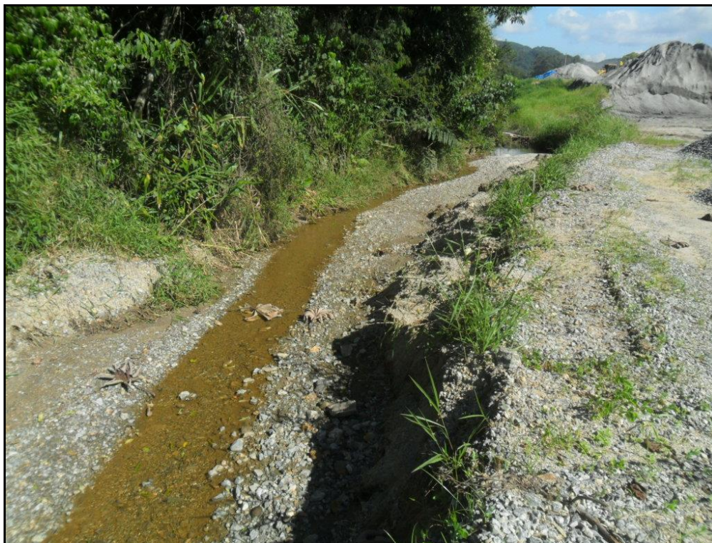
Figura 4, Vista da canaleta de drenagem implantada no empreendimento.
