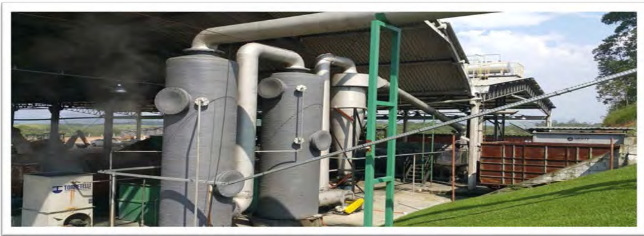
Figura 16 – Sistema de tratamento dos gases
