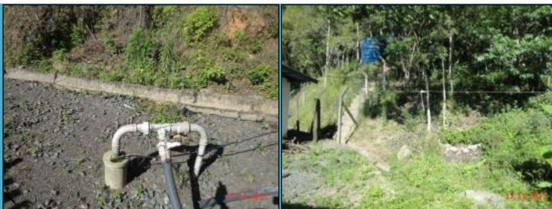
Poço tubular profundo (poço artesiano) e caixas para armazenamento d'água utilizada para o consumo.
