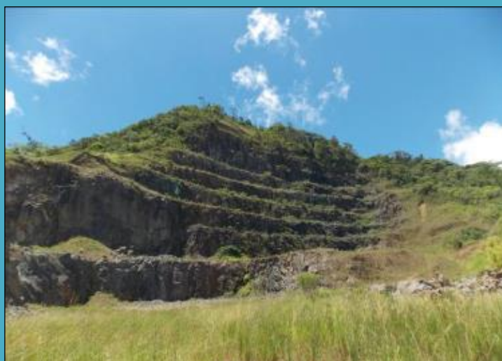
Os taludes de corte em rocha já existentes no local do empreendimento
