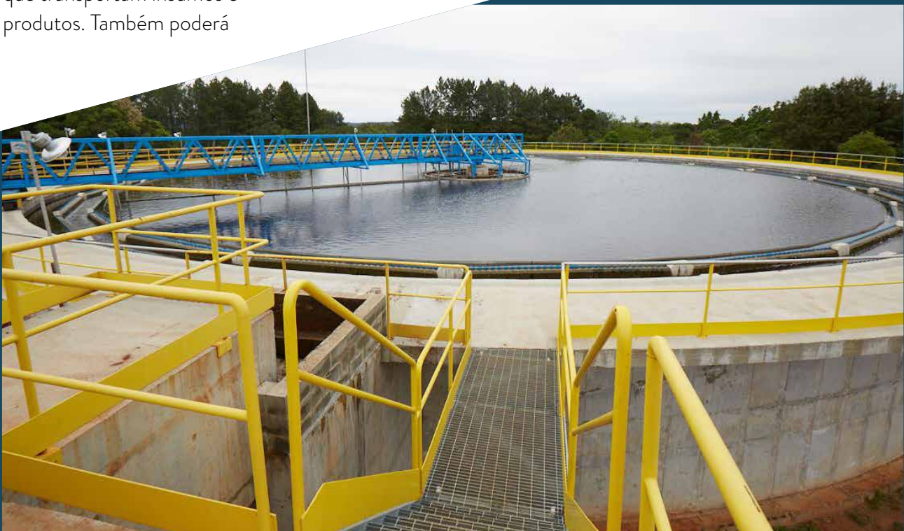
Estação de Tratamento de Efluentes (ETE)
