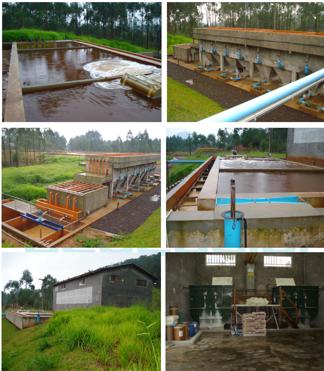
Figura 5 – Detalhes da estação de tratamento de efluentes da Mina Morosini.
