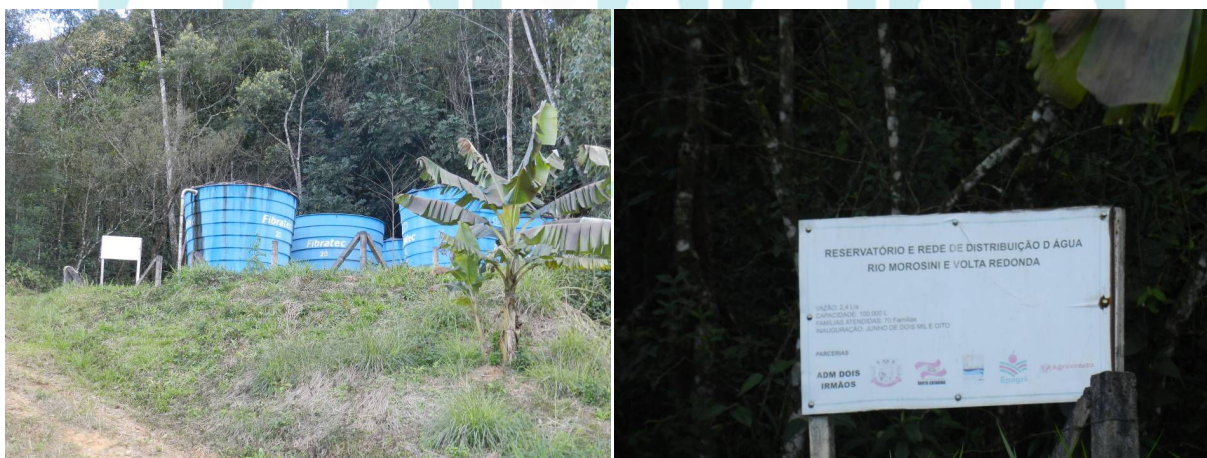
Figura 55 – Reservatório de abastecimento da Volta Redonda com 100 mil litros, e placa com dados do reservatório e das parcerias firmadas.
