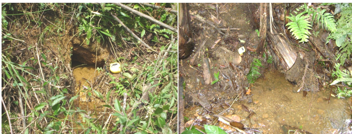
Figura 15 – Detalhe do modelo de conduto com descarga em canal das nascentes, que potencializa o processo erosivo promovido pela flutuação da água subterrânea (vossorocatização).
