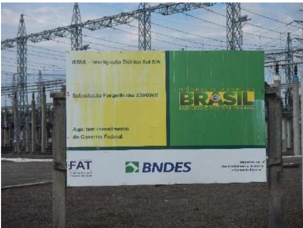
Foto 072: Subestação de Forquilha.
