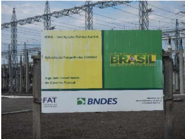
Foto 072: Subestação de Forquilha.
