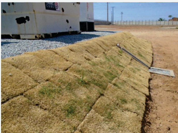
Exemplo de medida do PRAD: plantio de gramínea e implantação de drenagem pluvial no talude.
