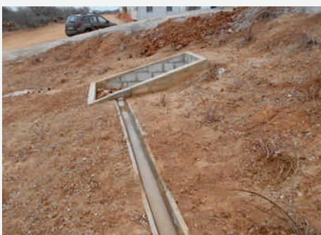
Exemplo de medida do PAC: controle de erosão e assoreamento - implantação de rede de drenagem em talude, visando à coleta e escoamento das águas pluviais.
