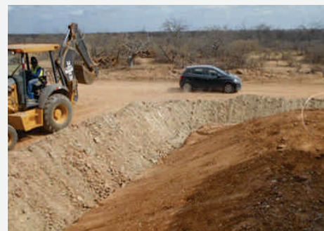
Exemplo de medida do PAC: controle de erosão e assoreamento - implantação do sistema de drenagem, para realizar a coleta e o direcionamento das águas.
