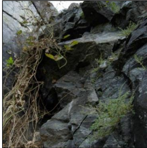
Figura 5-9: Gnaiss fraturado e à esquerda é possível observar uma parede lisa. Fonte: do autor.
