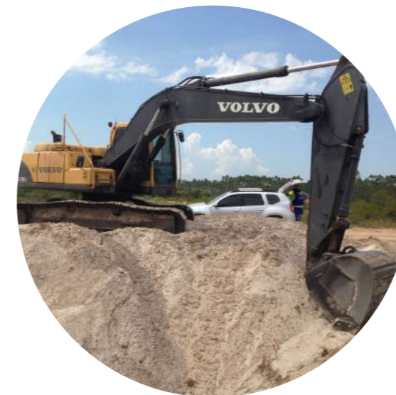
Desmorte mecânico da areia com escavadeira hidráulica para carregamento em caminhão basculante e transporte até as instalações de beneficiamento.
