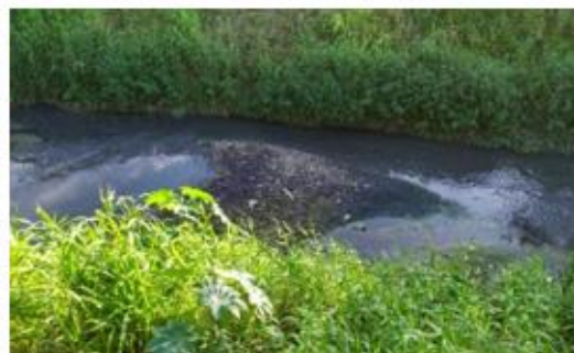
Rio Itaum-Mirim com ponto de assoreamento, na rua dos Baobás
