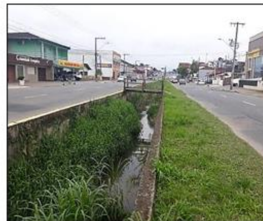
Assoreamento no rio Itaum-Açu (ponto 8)
