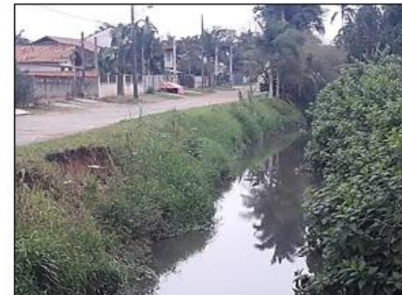
Solapamento de margens (ponto 3)
