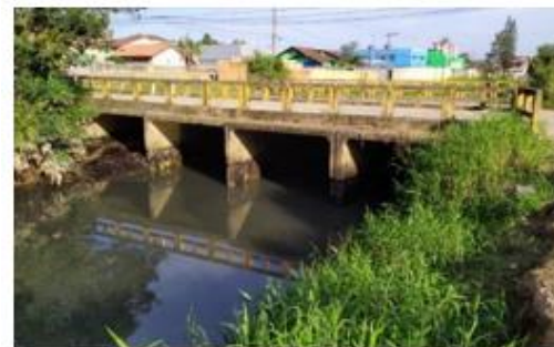
Ponte com muro de concreto, no rio Itaum-Mirim, na rua Passo Fundo
