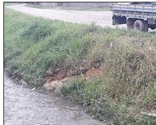
Solapamento de margens (ponto 2)
