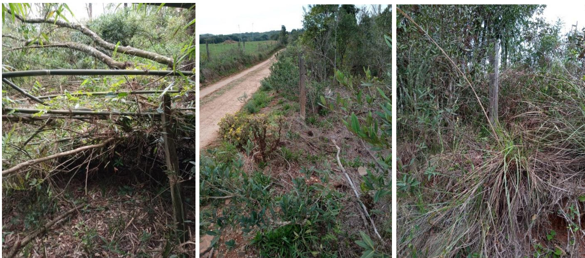
Foto 01.: Cercamento antigo que necessita de manutenção
