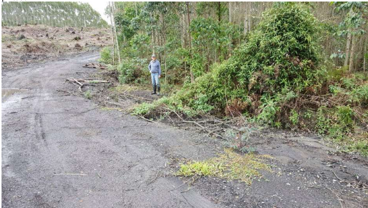
Figura 7 - Detalhe do local por onde o material piritoso é carreado para o vale que contém a nascente 2 (onde posiciona-se o técnico). Nota-se que a própria via de acesso era construída com material piritoso.
