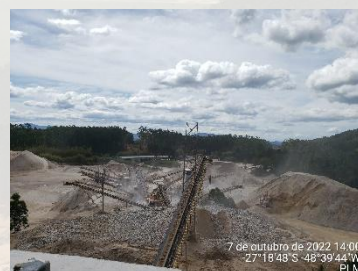
Sistema de alimentação do beneficiamento da PLM
